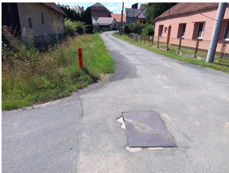
9. .... Místní komunikace asfaltové starší ....
